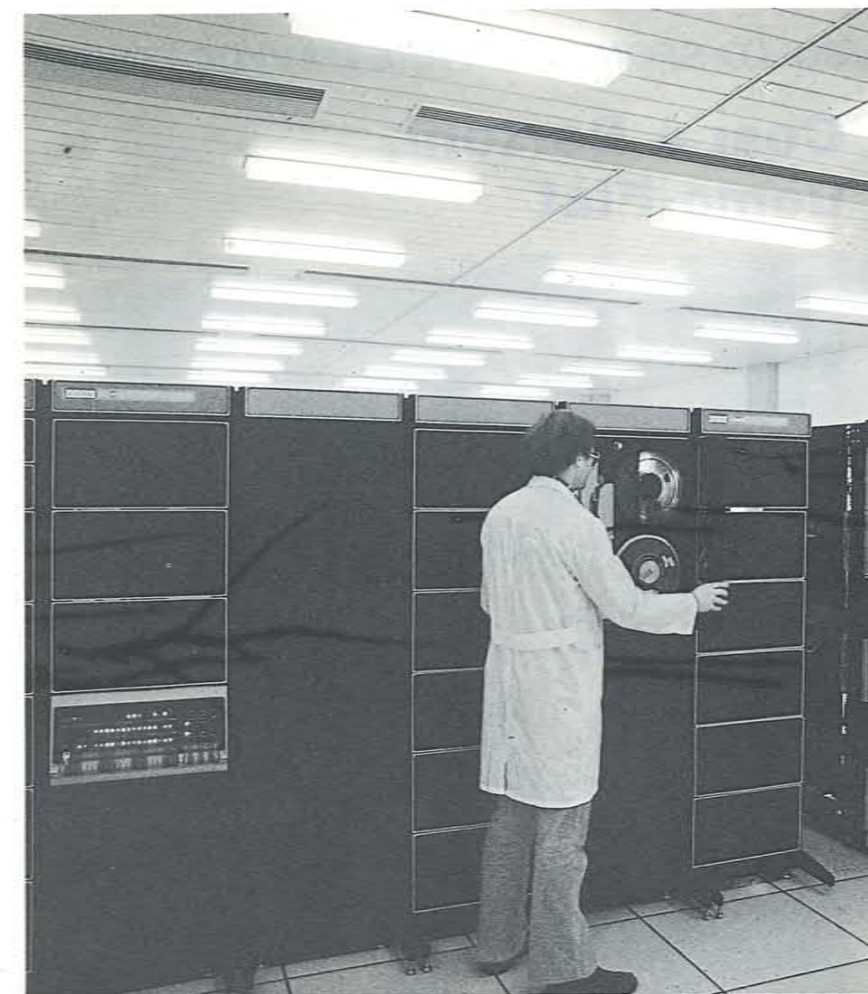
Sopra: una delle sale di sviluppo dei «sistemi di supervisione e controllo» nello stabilimento di Rieti. Sotto: la sala di controllo degli impianti idrici dell'Acqa di Roma, prodotto dalla Telettra di Rieti. Pagina accanto in alto: lo stabilimento di Rieti.
